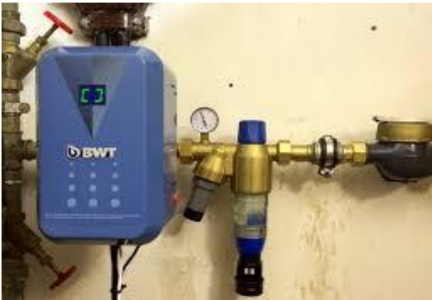
Afbeelding 13. Bewados toestel om stoffen te injecteren die de waterkwaliteit of leidingen stabiel houden.
